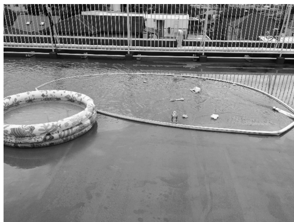
写真3 消火栓のホースによる水たまり
